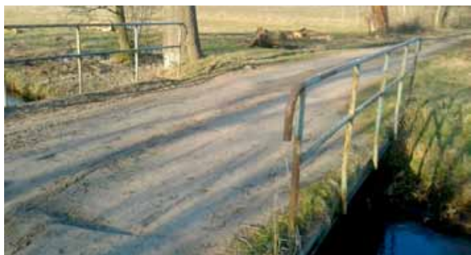
Tak było przed remontem
