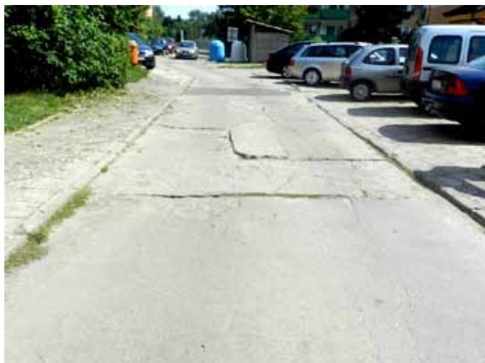
Tak było przed remontem
