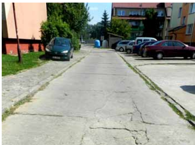
Tak było przed remontem
