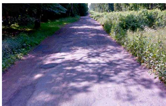
Tak było przed remontem
