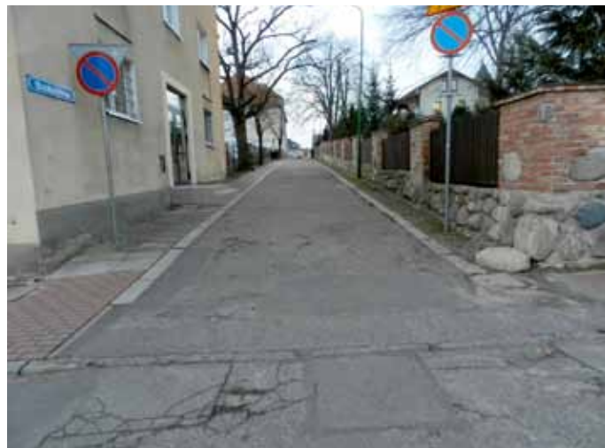
Tak było przed remontem
