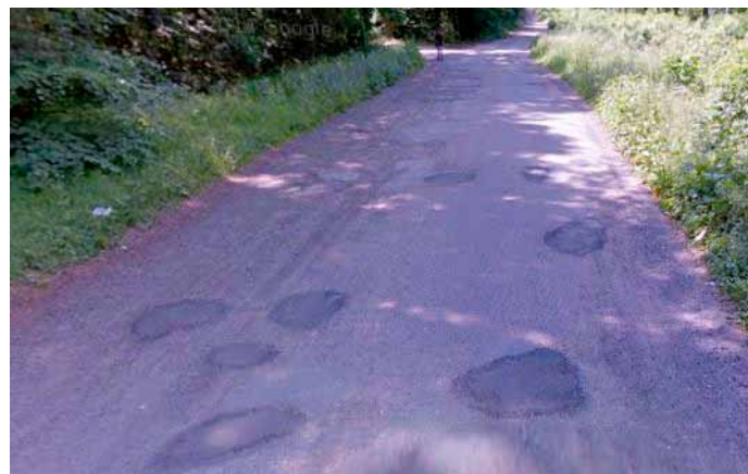
Tak było przed remontem
