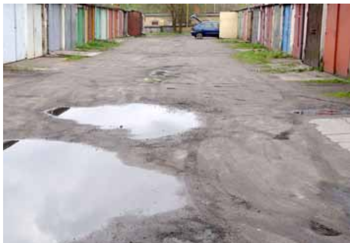
Tak było przed remontem
